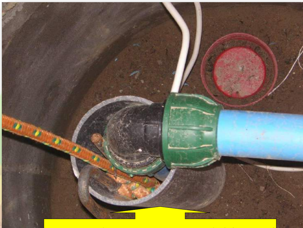
Rura osłonowa pompy głębinowej
